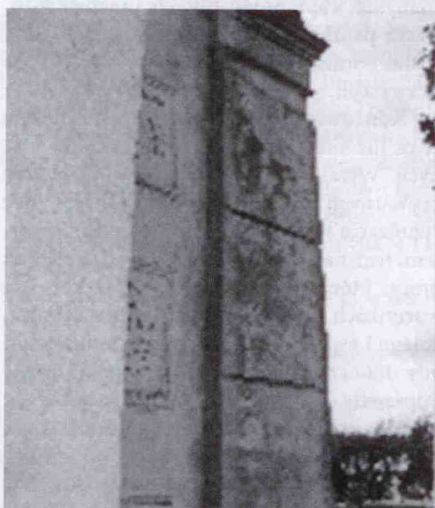
Foto-2: kolorowy zaciek na tynku od drogi po prawej stronie - 2015r.
