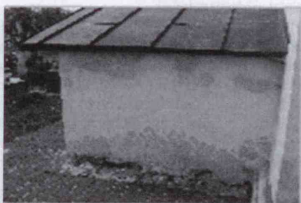
Foto-4: daszek bez rynny, widoczne zacieki na tynku pod nim, oraz niszczenie fundamentu,
