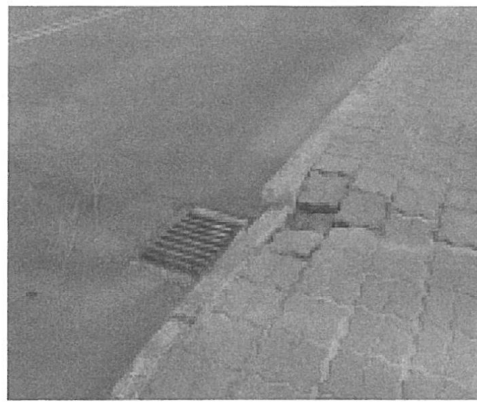
Foto 2- chodnik po tej samej stronie - początek konstrukcji mostu, w lewo widać już wcześniejsze pęknięcia asfaltu
