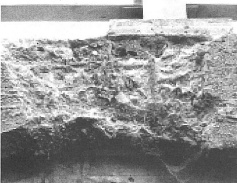
Foto 7- widoczne odsłonięte zbrojenie konstrukcji przęsła mostu, po lewej stronie od źródła Tanwi,
