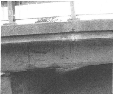
Foto 4- pęknięcie przęsła mostu - widziane od strony źródła Tanwi, po prawej stronie mostu, przy 5 podpórze.
