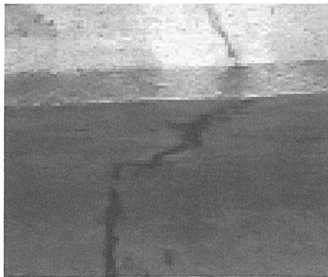
Foto 5- powiększenie tego pęknięcia, w żelbetonowej konstrukcji mostu!
